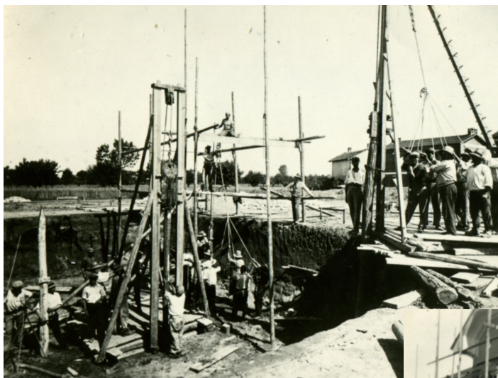
In questa foto si vedono i lavori di scavo per le fondamenta dell'edificio
